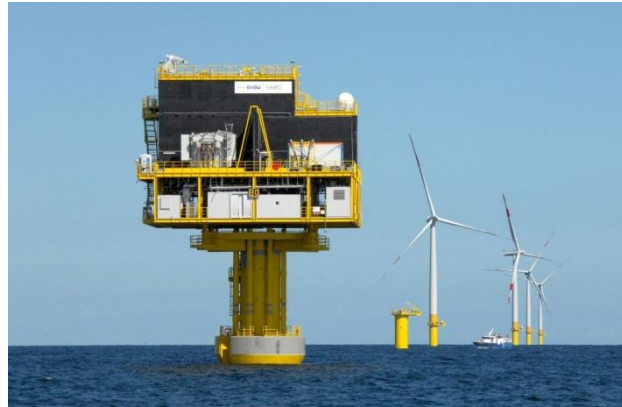
Abbildung 4-8: Umspannwerk „Baltic 1“ von 50 Hertz Offshore 222
